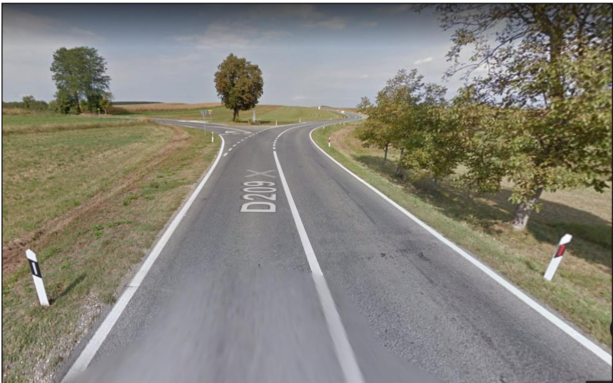
Slika 15. Pogrešan poprečni nagib ceste DC209
