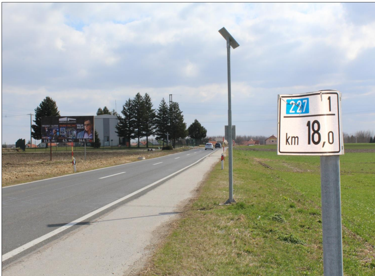
Slika 16. Stanje ceste DC227 na dionici Brezje - Šenkovec
