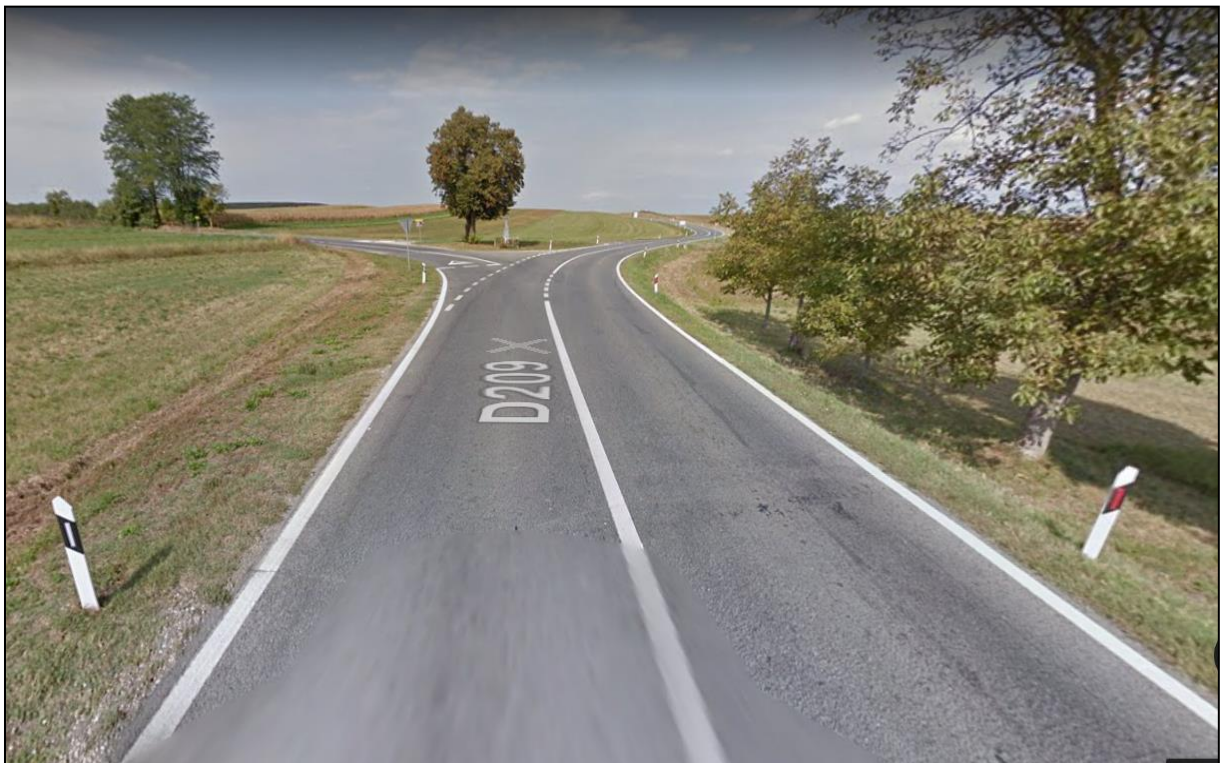
Slika 15. Pogrešan poprečni nagib ceste DC209
