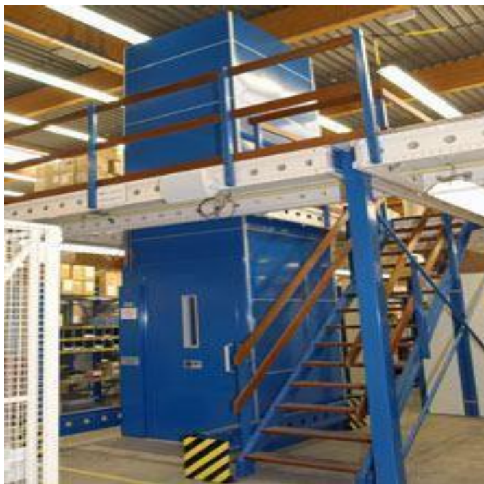
Slika 4. Dizala u skladištu, Izvor: https://www.adrialift.hr/view.asp?idp=4&c=42
