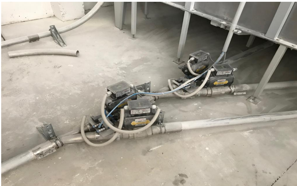
Slika 7. Uređaj za pneumatski transport u skladištu brašna, Izvor: vlastita izrada autora
