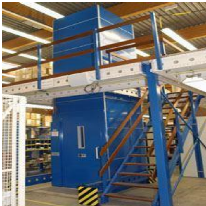
Slika 4. Dizala u skladištu, Izvor: https://www.adrialift.hr/view.asp?idp=4&c=42
