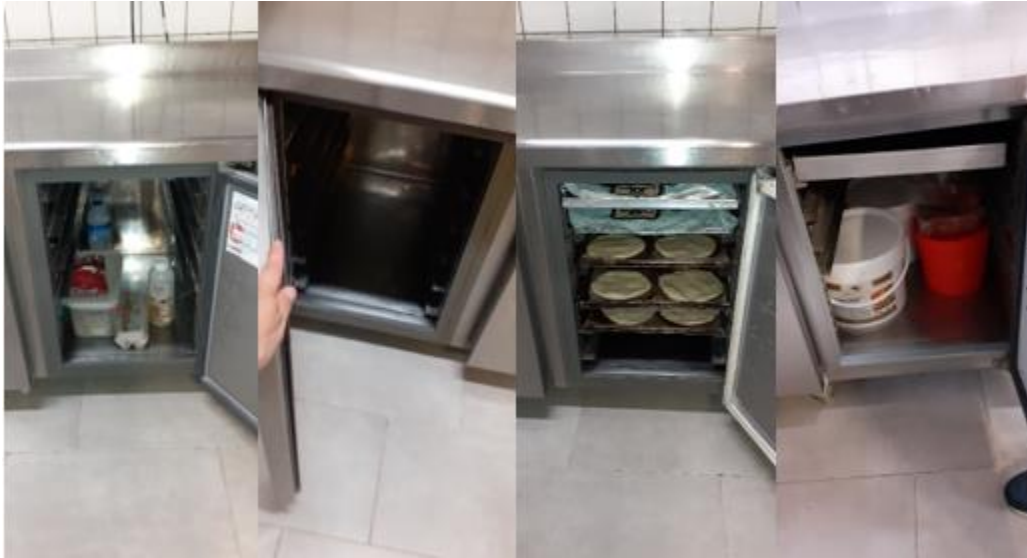
Slika 39 Prikaz malih rashladnih uređaja u prostoru za proizvodnju
