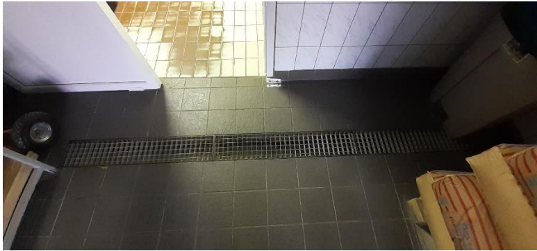
Slika 33 Odvodni kanal u skladištu
