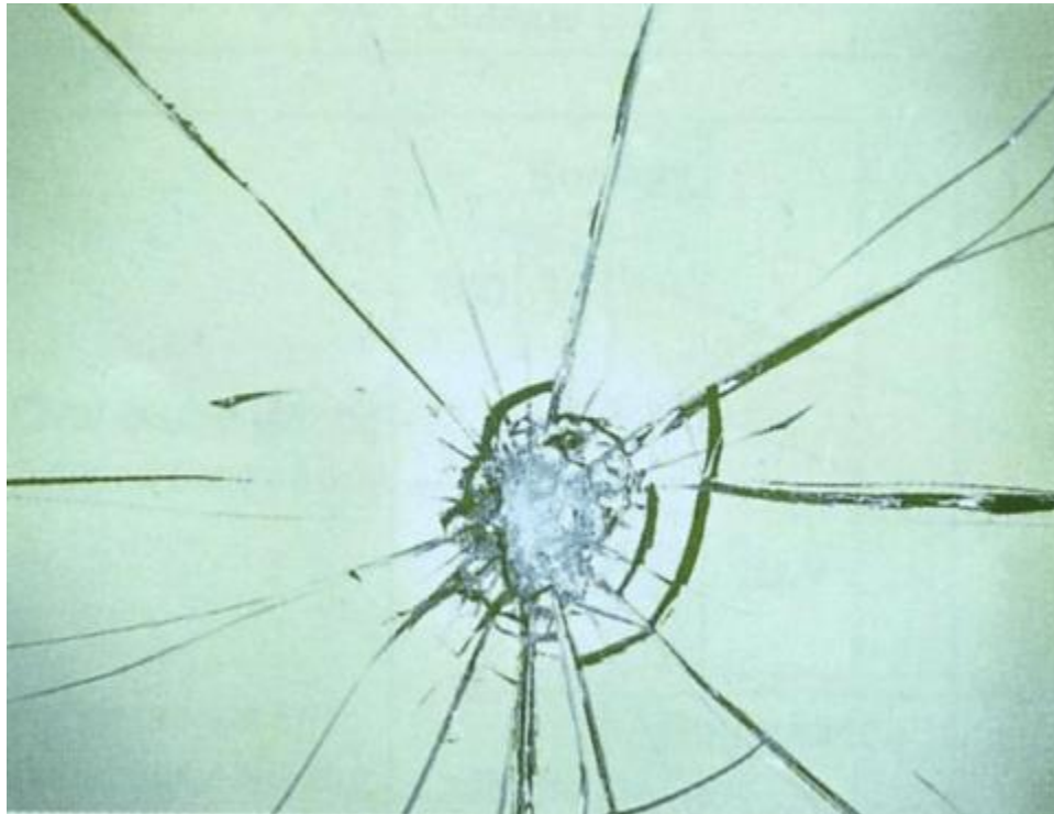
Slika 10. Puknuće višeslojnog stakla
