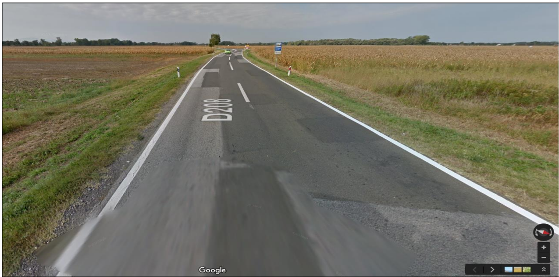
Slika 11. Stanje ceste DC208
