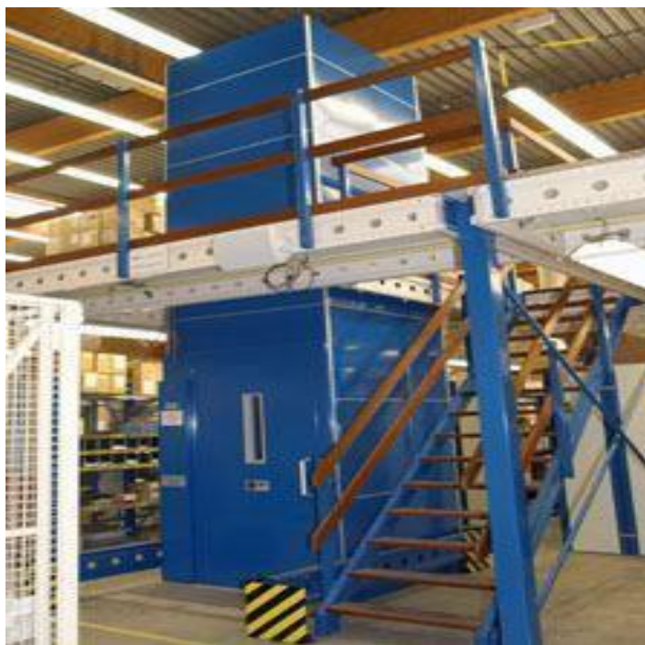
Slika 4. Dizala u skladištu, Izvor: https://www.adrialift.hr/view.asp?idp=4&c=42
