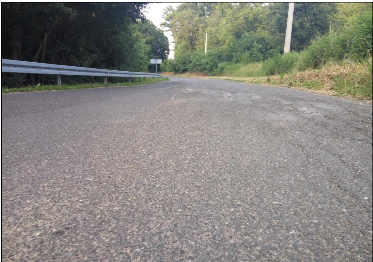
Slika 20. Oštećenje ceste ŽC2533
