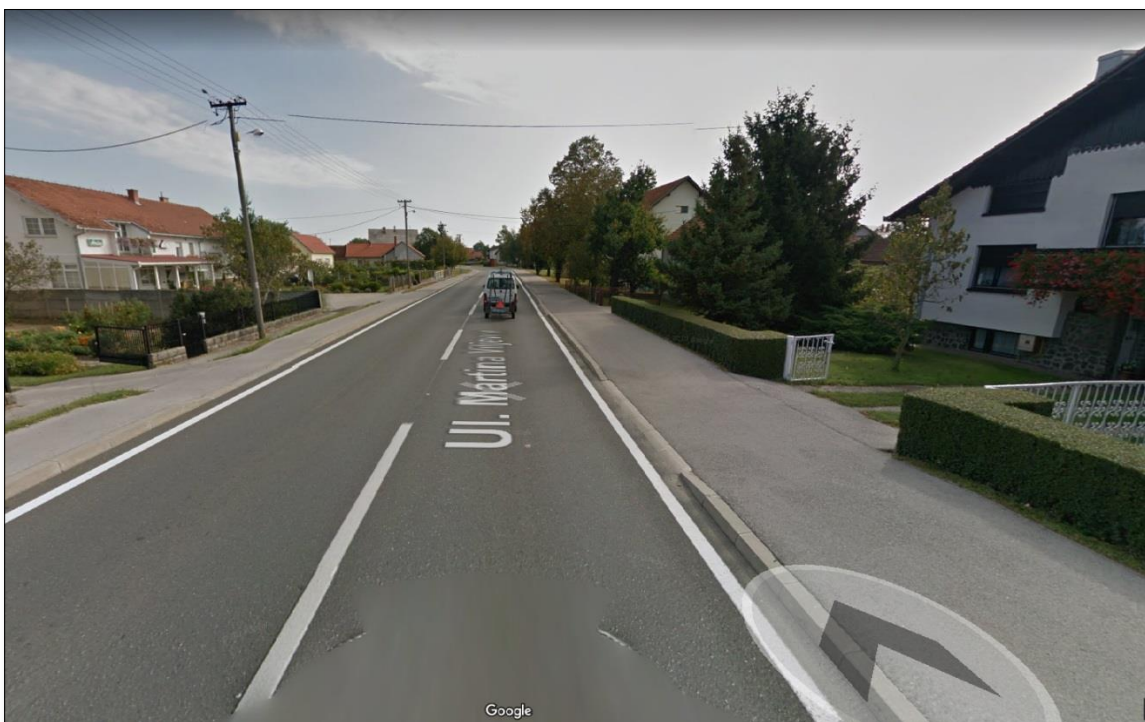
Slika 12. Stanje ceste DC208 u Nedelišću
