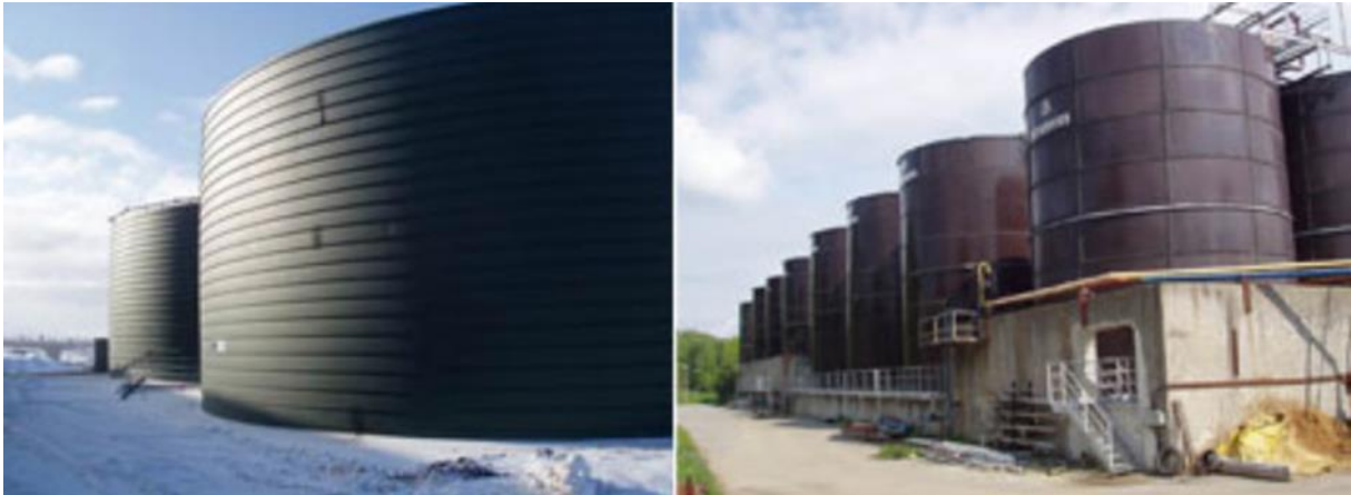
Slika 5. Čelici i betonski digrestor.
