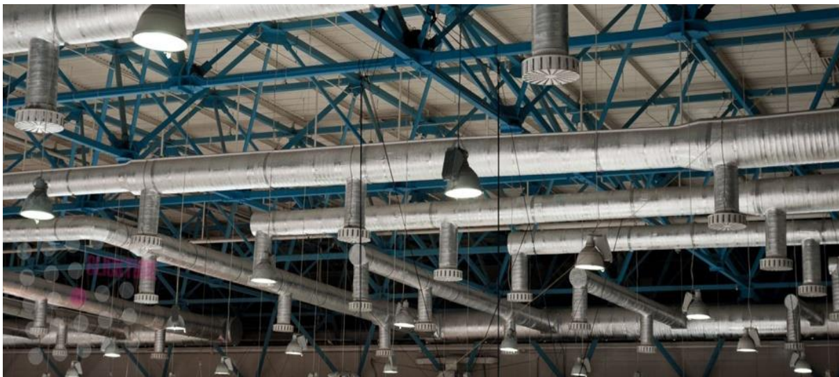
Slika 24. Ventilacija skladišta, Izvor: https://vvsc.ru/hr/ventilation-system-for-industrial-premises-ventilation-in-production/
