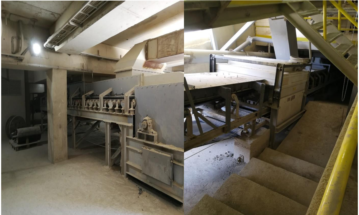
Slika 24. Pokretna traka pod drobilicom (lijevo) te traka sa analizatorom sirovine (desno)
