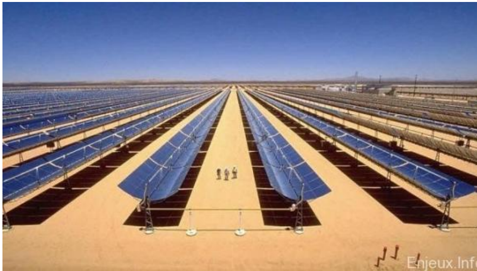
Slike 3. Solarna elektrana.
